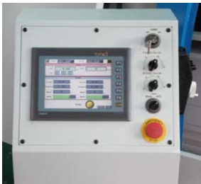
人機操作介面 HMI control panel
